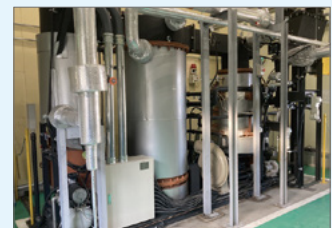
茨城工場のバイオマスボイラー
