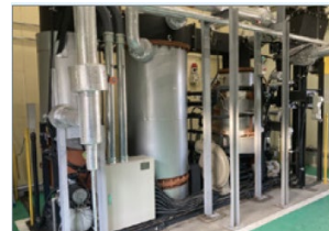
茨城工場のバイオマスボイラー
