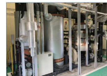
茨城工場のバイオマスボイラー
