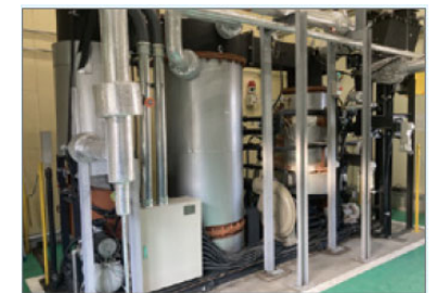
茨城工場のバイオマスボイラー
