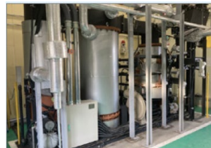
茨城工場のバイオマスボイラー
