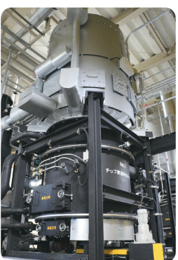
バイオマス蒸気ボイラー Biomass steam boiler
