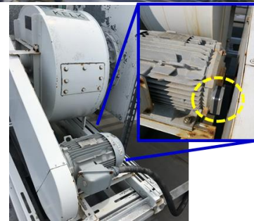
図 15 KELK の工場および屋上設置モータに設置した熱電 EH 無線デバイス
