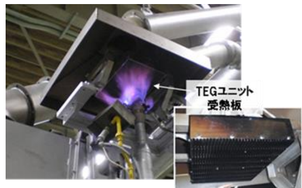
図6 工業炉アフターバーナーの排熱利用熱電発電の実証試験
